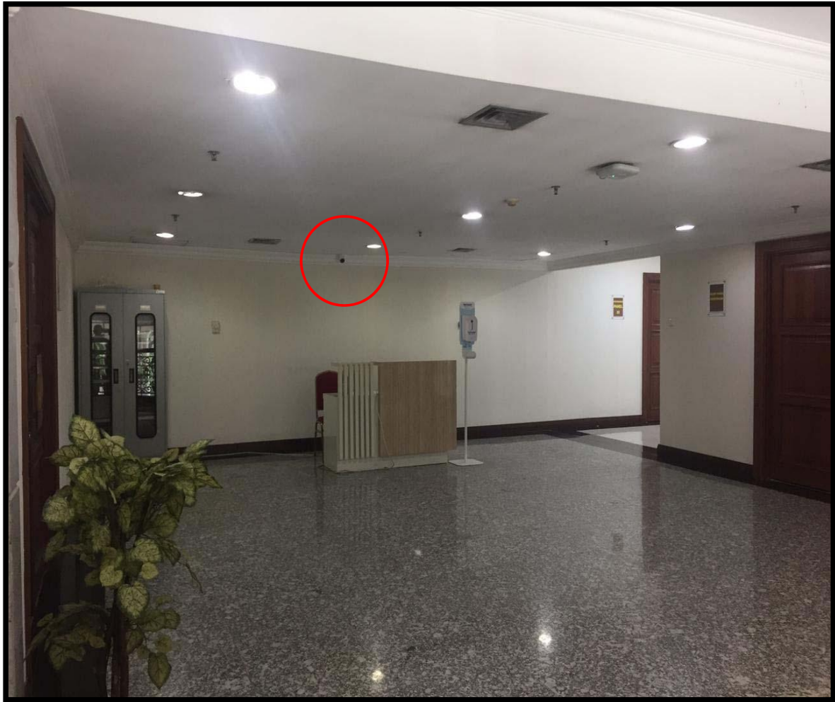
CCTV yang dipasang pada area Ruang Sidang Panel Lantai 4 Gedung I Mahkamah Konstitusi
