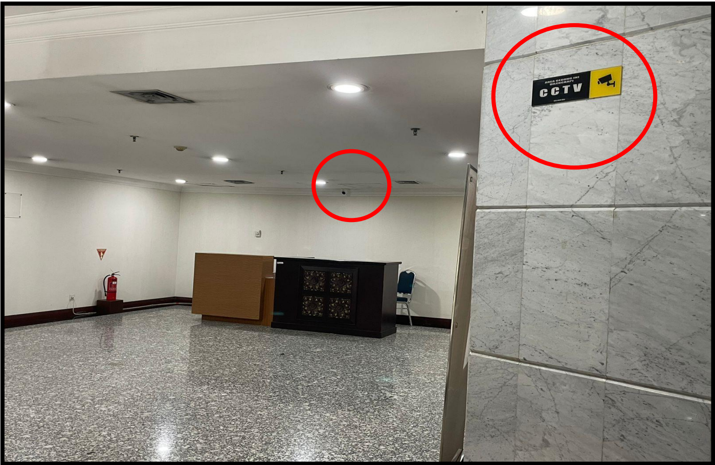
Penempatan CCTV pada area ruang tunggu sidang
